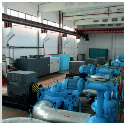
ВНУТРИ ПОМЕЩЕНИЯ НАСОСНОЙ СТАНЦИИ
