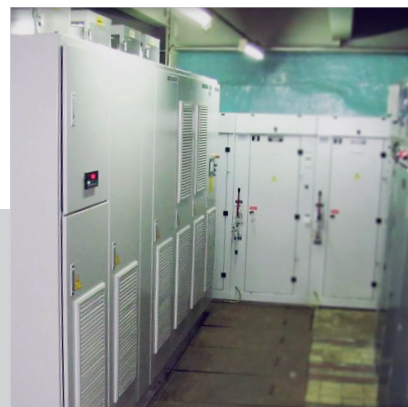
УСТАНОВКА ВНУТРИ ЩИТОВОЙ
