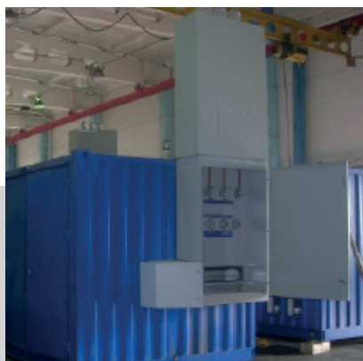
КОНТЕЙНЕРНОЕ, ВНУТРИ ПРОИЗВОДСТВЕННОГО ЦЕХА
