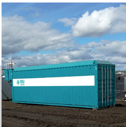
КОНТЕЙНЕРНОЕ ИСПОЛНЕНИЕ (МОБИЛЬНОЕ)
